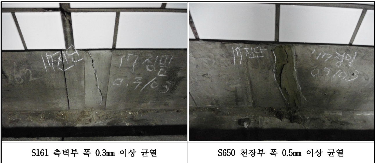
【사진 3.4】측벽부-균열 손상현황
