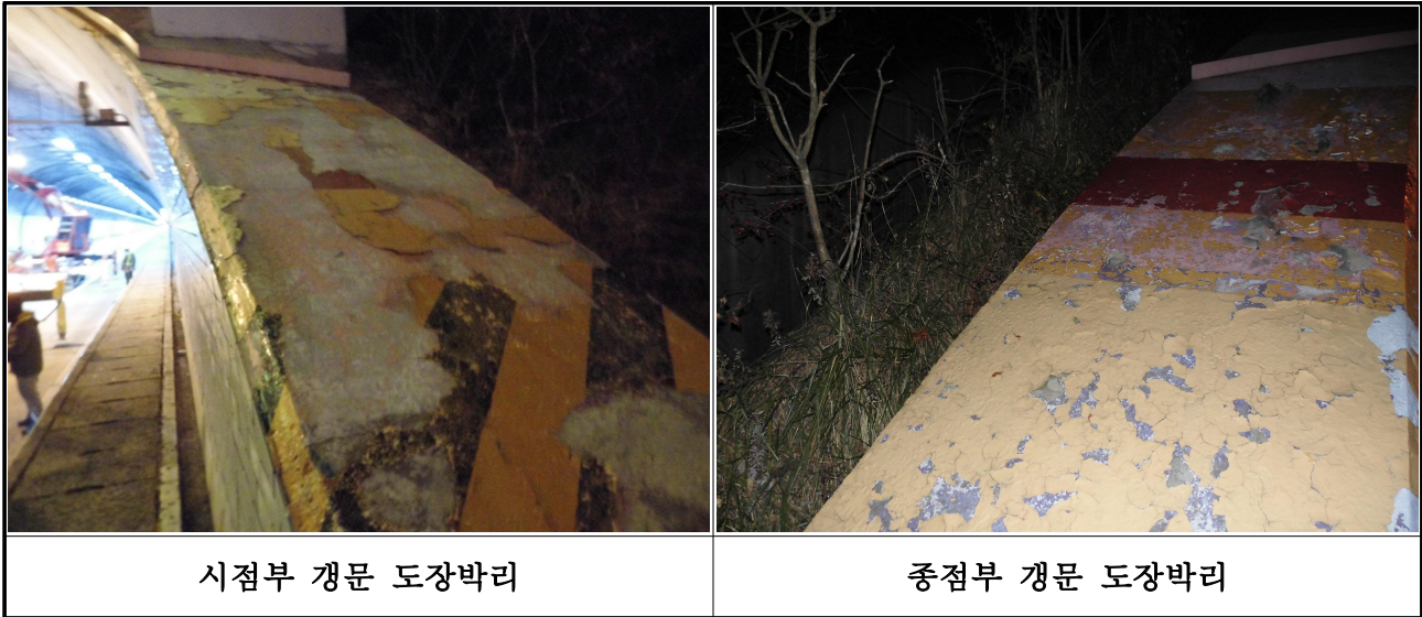
【사진 3.7】갯문 손상현황
