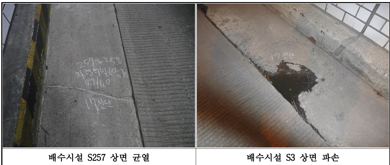
【사진 3.10】 배수시설 손상현황
